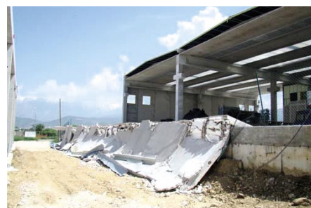
Slika 8 • Porušitev montažnih panelov v montažni hali (Vir: ASSOBBETON)
