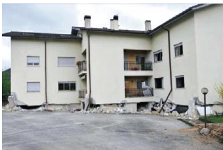
Slika 4a • Porušitev pritličja stanovanjskega bloka v Pettinu
