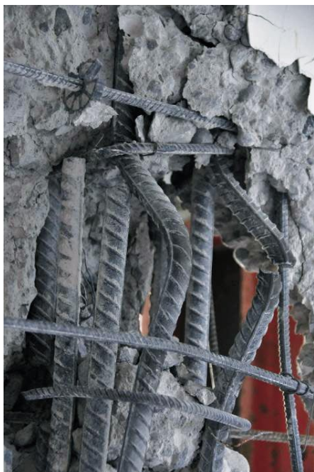
Slika 10c • Porušitev in uklon palic na mestu preklopa armature
