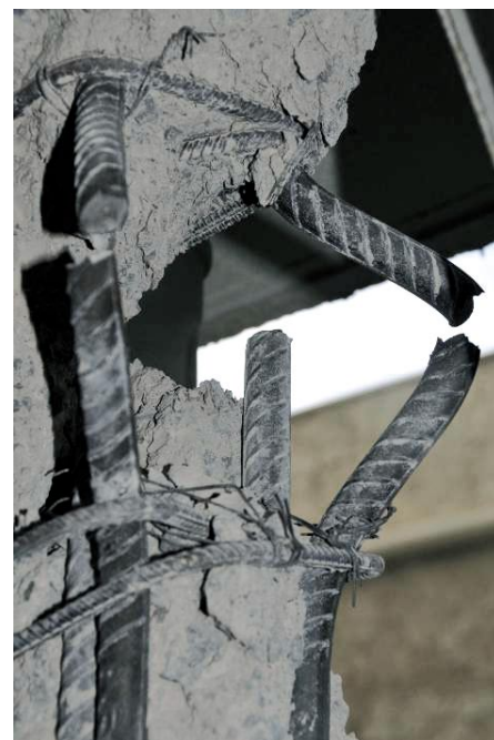
Slika 10b • Značilen pretrg vogalne navpične armature zaradi sosednja plastifikacije in uklona
