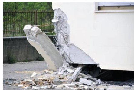
Slika 4b • Neduktilni detajli brez zadostnih stremen v stebrih ob garažni odprtini
