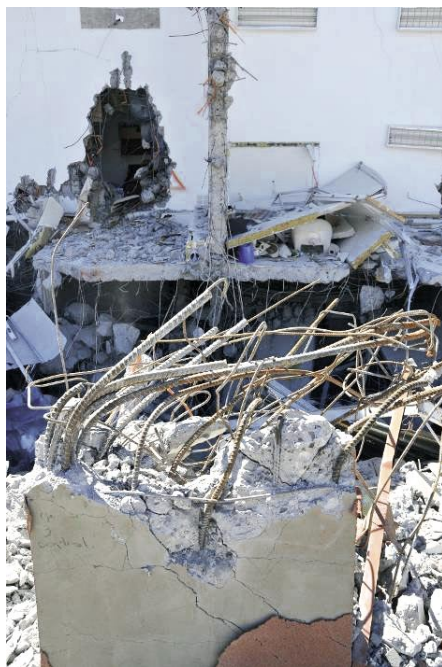
Slika 14b • Vsa armatura v pritličju je bila preklopljena na isti višini na mestu preloma
