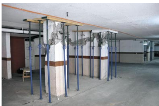
Slika 11 • Značilna porušitev sten v prvi kletni etaži
