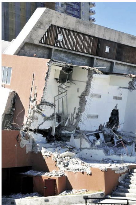
Slika 14a • Pogled na mesto preloma v pritličju stavbe Alto Rio
